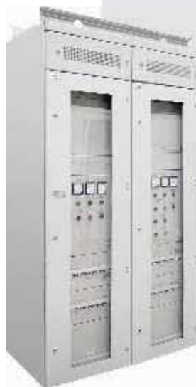
Шаф для собственных нужд переменного тока
