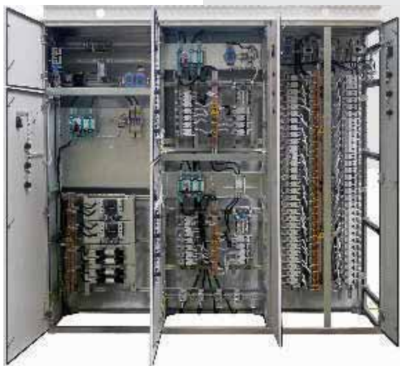
Щит распределения электроэнергии постоянного тока
