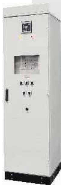
Шкаф регулирования напряжения трансформатора под нагрузкой ШМРН
