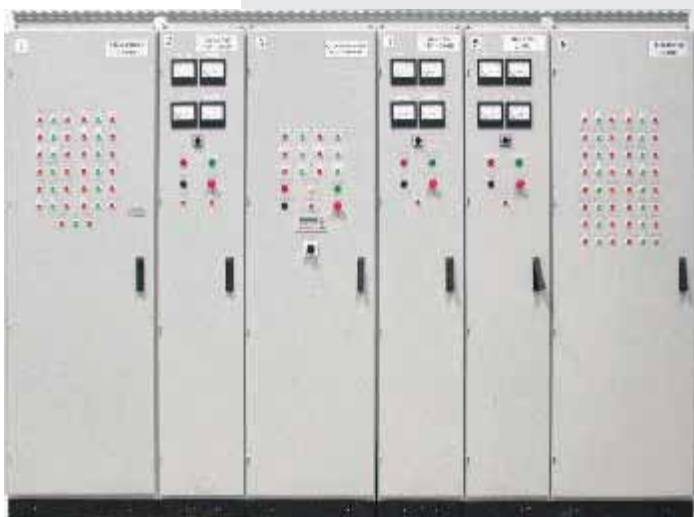
Шафы автоматического ввода резерва (АВР) на базе микропроцессорных контроллеров
